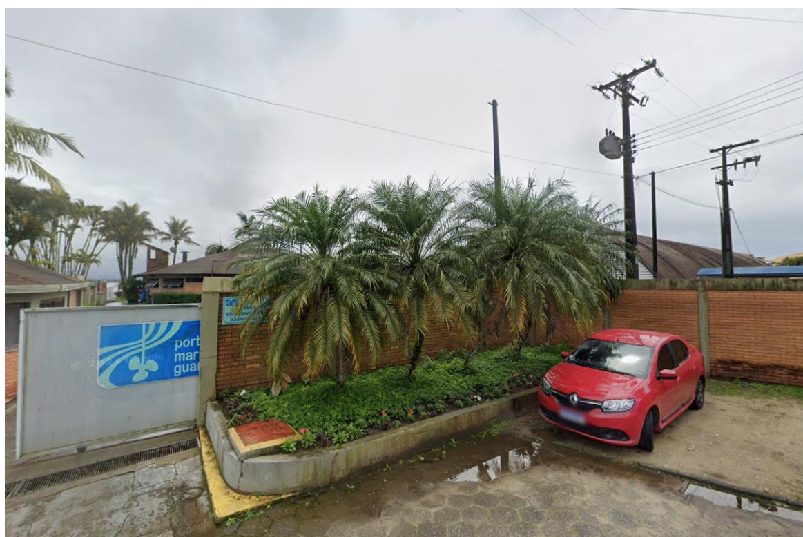
Figura 20 – Poste com transformador dentro do empreendimento. Fonte: Google Street View, 2023.
